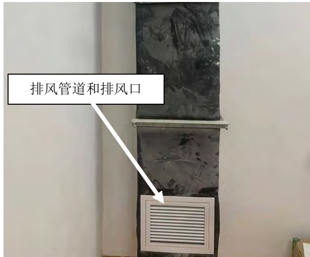
通风系统排风口
