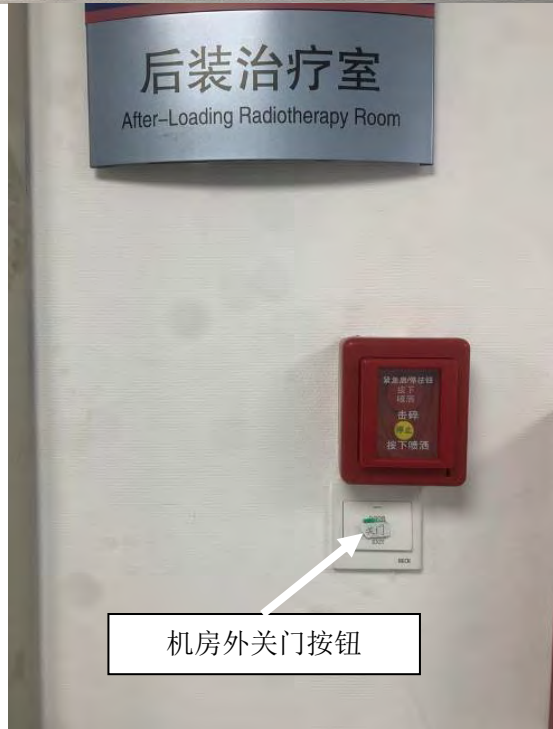
迷道内紧急开门按钮和门外关门按钮
