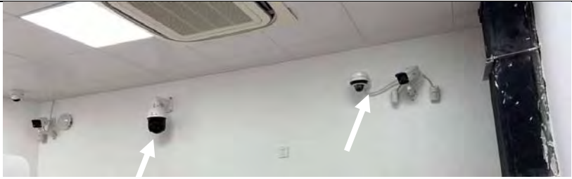
闭路监视系统摄像头
